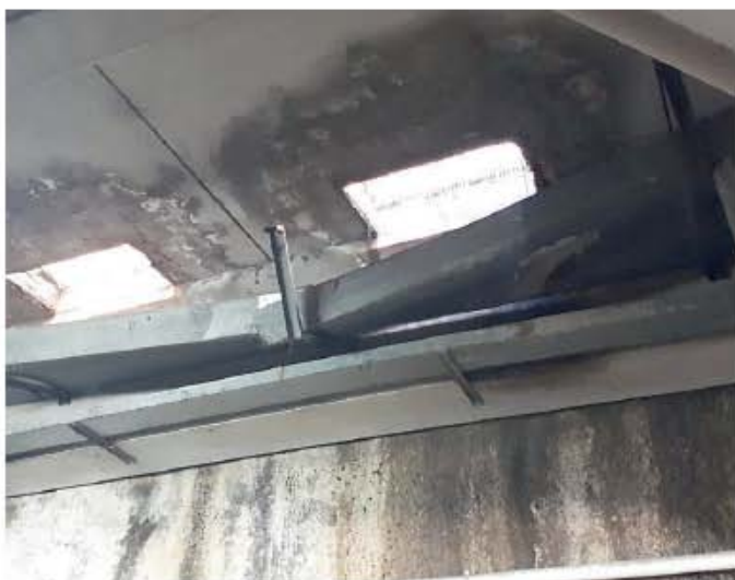
Cedimento nel parcheggio sotterraneo del Terminal bus
